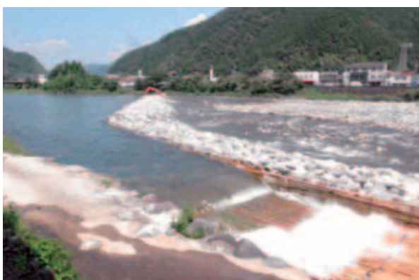
写真4 郡上八幡の長良川に設置された観光ヤナ。
