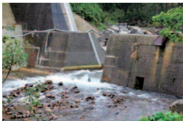
写真6 知床半島羅臼川砂防ダムに新設されたスリット式魚道。
